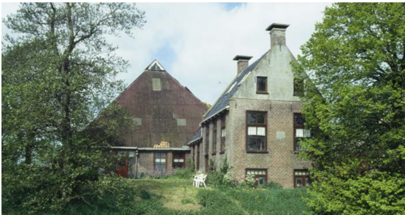
It Westerhûs in vervallen staat gezien vanuit het oosten omstreeks 2017 (foto: bouwhistorisch onderzoek drs. F.J. van der Waard en drs. M.R.C. van Voorn)
