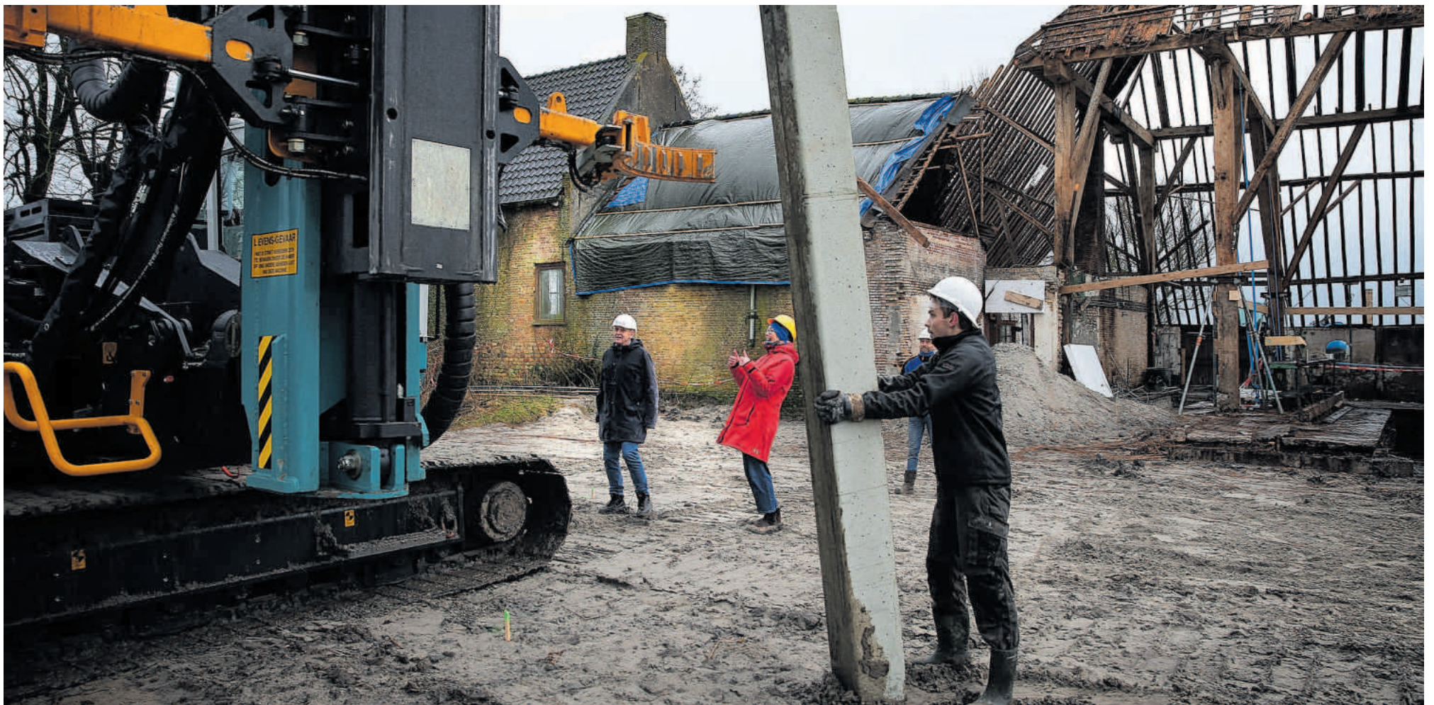
Met het heien van de symbolische eerste paal begon donderdag officieel de start van de bouw van klooster Westerhûs bij Hilaard, een initiatief van Nijkleaster. De monumentale boerderij wordt gerestaureerd en er komt nieuwbouw van drie kloosterappartementen en negen gastenkamers. Over een jaar moet het klaar zijn. Pagina 10 Foto: Catrinus van der Veen
